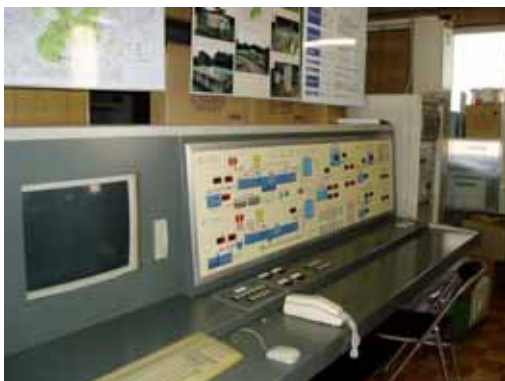
「水道施設監視装置」
