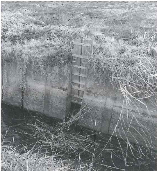
蓬田地区に比べ、小平地区の多くは止水板を使用している
