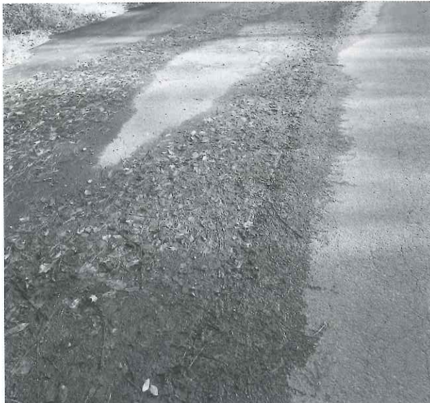
村道煙石線 何度か修繕工事を行ってきたが、湧水が発生している
