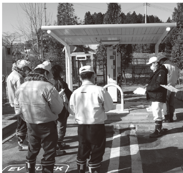
道の駅ひらたの電気自動車用充電設備
