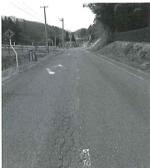
センターライン・側線等が消えており、早期の解消が望まれる。
