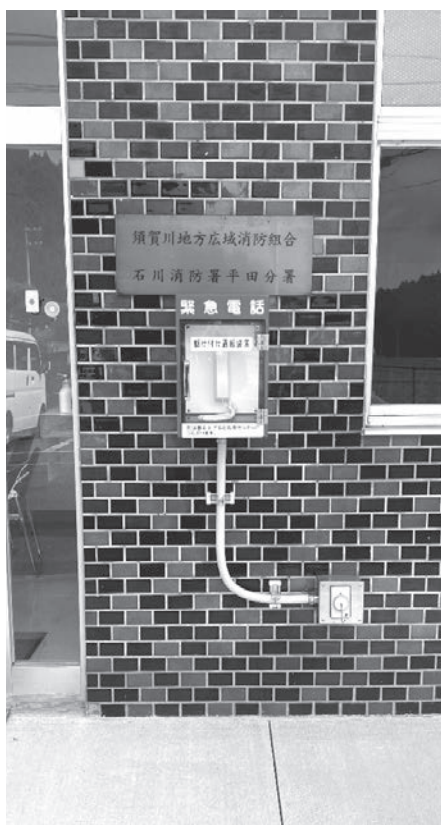
平田分署 設置状況
