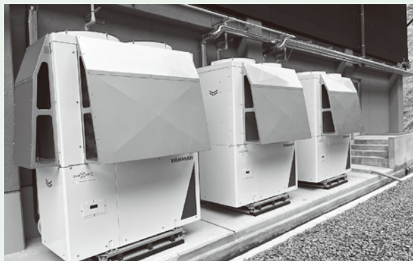
勤労者体育センターエアコン(室外機)
