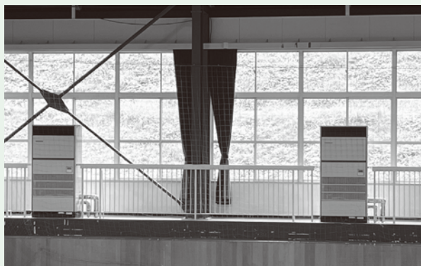
勤労者体育センターエアコン(室内機)
