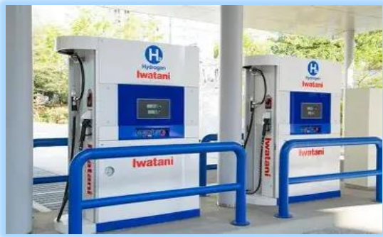
水素ステーション
