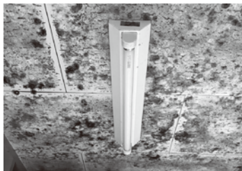
天井の雨漏り箇所
